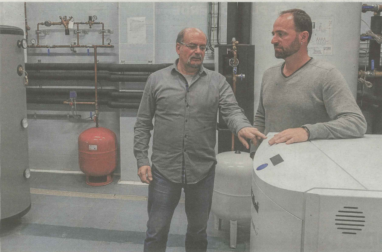
Patxi Vaquerizo e Isidro Zaldúa, en la sala de calderas del edificio de energías renovables. :: MICHELENA
