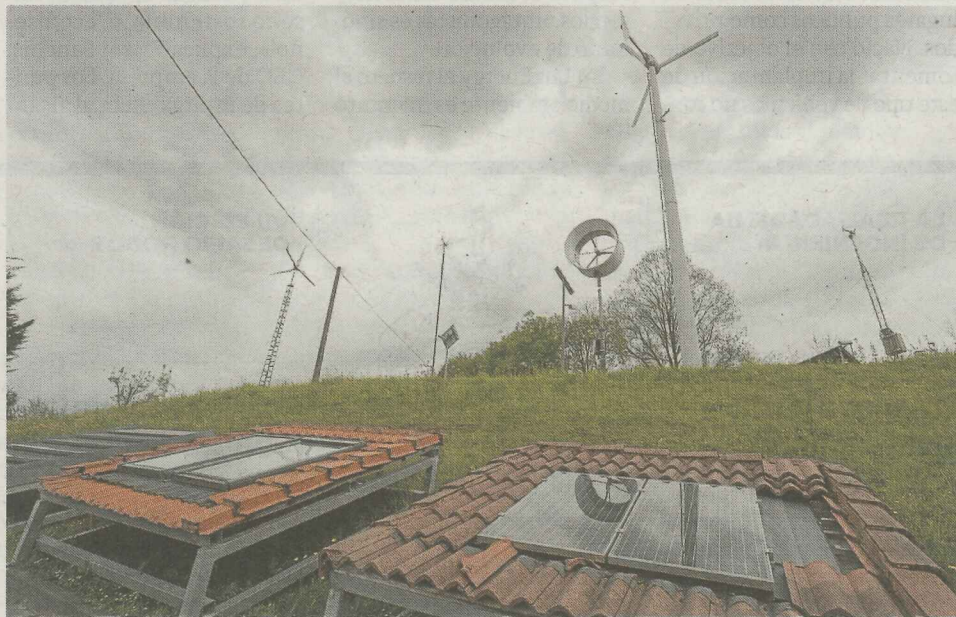
Aerogeneradores y placas solares en el exterior de la escuela. :: MICHELENA
